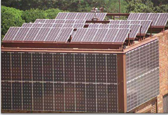
منظومة خلايا شمسية لا مركزية مربوطة بشبكة الكهرباء
